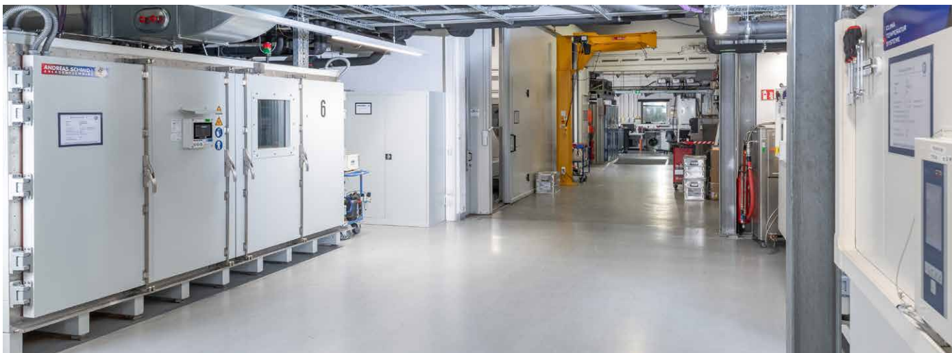
■ Klimakammern für große Batteriepacks im Batterie-Testlabor des TÜV SÜD in Garching bei München.
