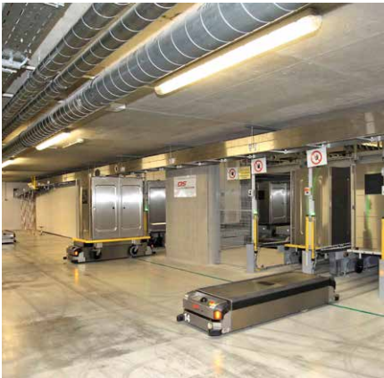
▲ FTS in unterirdischen Versorgungsgängen zum Transport von Edelstahlbehältern (Bild: DS Automotion)
